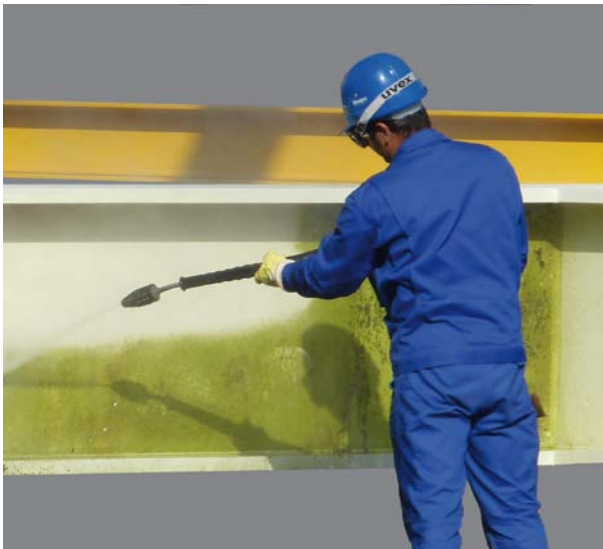
Abb. 16: Verschmutzte Brandschutzbeschichtungen lassen sich durch Abblasen, Absaugen oder leichtes Abbürsten reinigen. Einige Beschichtungen können sogar mit dem Hochdruckreiniger gesäubert werden.
